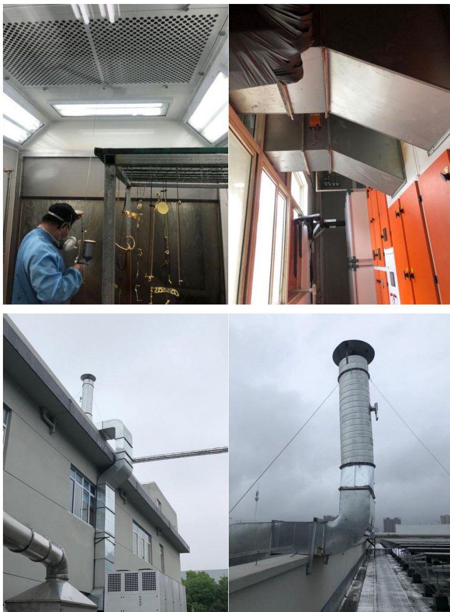
图 4-4 喷漆废气治理设施现场照片
