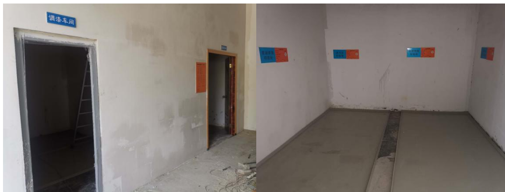
图 4-7 危废仓库现场照片
