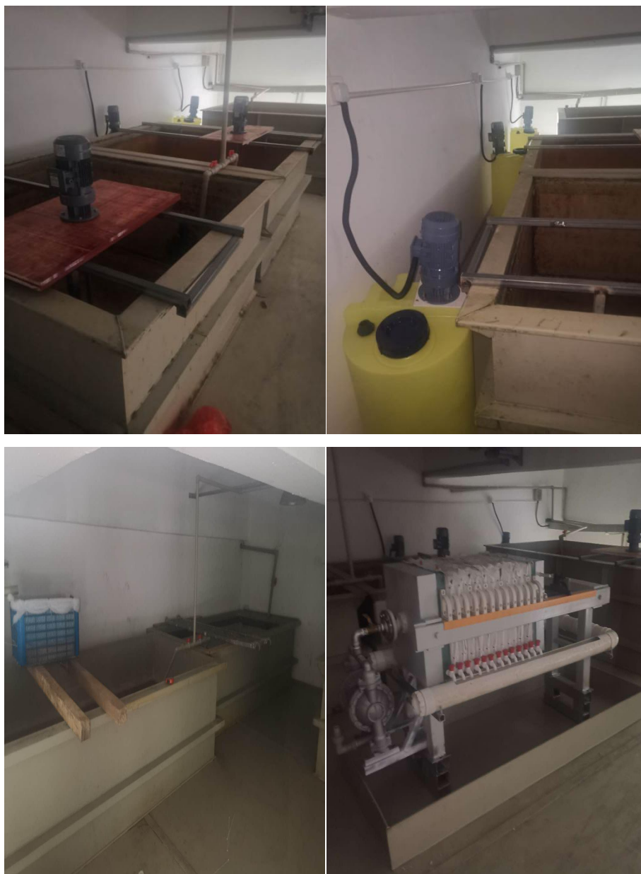
图 4-1 废水处理设施现场照片
