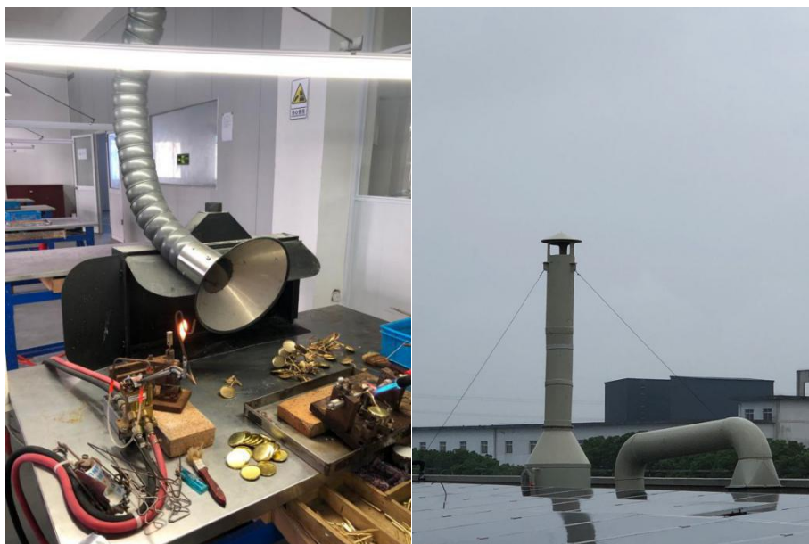
图 4-2 烧焊废气治理设施现场照片
