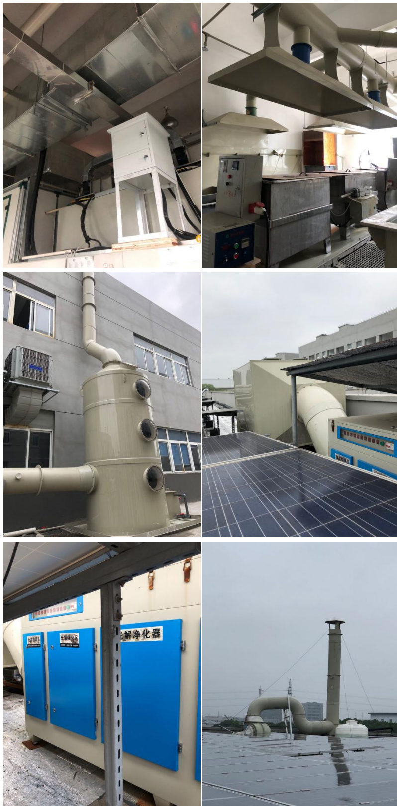
图 4-5 烘干、脱漆废气治理设施现场照片
